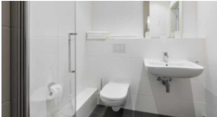
Bild 5 + 6: Die funktionalen aber elegant gestalteten Badezimmer aller Apartments wurden mit Systemtechnik von TECE realisiert.
