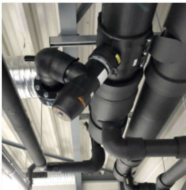
Bild 4a und 4b: Installation in einer Industrieanlage
