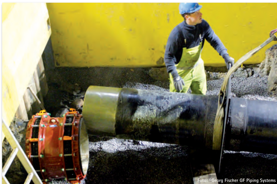
Bild 3: Es wurden zwei MULTI/JOINT® 3000 Plus Kupplungen DN600 mit EPDM Dichtelement sowie eine MULTI/JOINT® 3000 Plus Kupplung DN500 mit EPDM Dichtelement verbaut.
