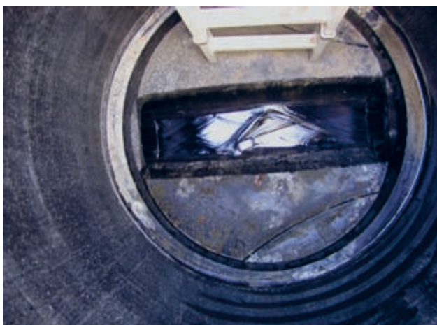
Kunststoffschacht nach mehrjährigem Betrieb
